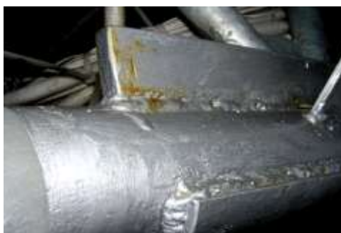
Rys. 14. Niedokładności malowania konstrukcji
