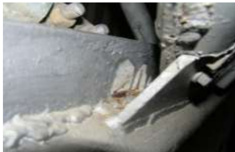
Rys. 13. Niedokładności malowania konstrukcji
