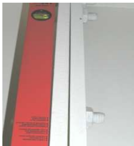
Rys. 6. Deformacje styku doczołowego
