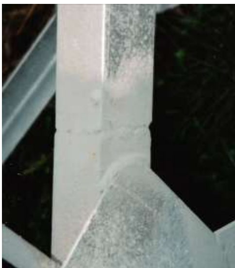
Rys. 10. Osłabienie krawężnika wieży
