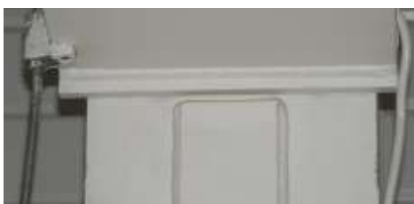
Rys. 7. Niedopasowanie elementów konstrukcji
