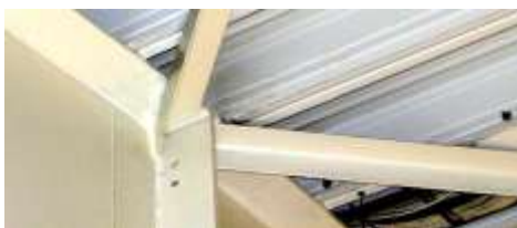
Rys. 8. Błędy projektu i prefabrykacji
