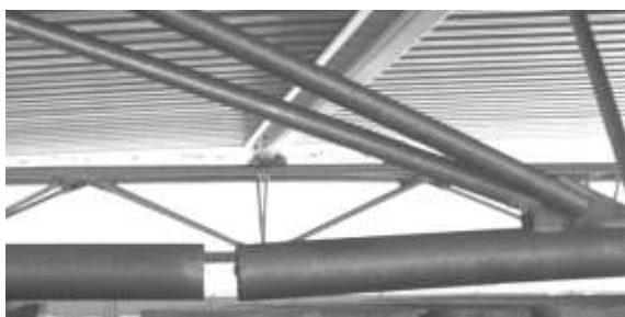
Rys. 2. Przykład uszkodzenia pasa dolnego w styku spawanym
