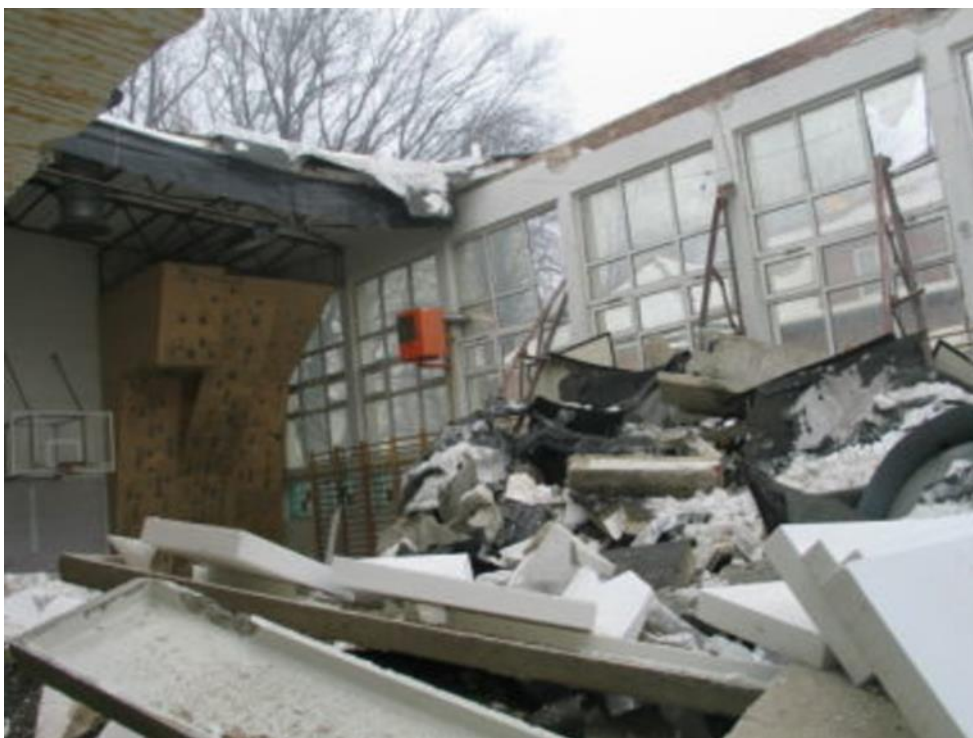
Fotografia 1 Rok 2009 w szkole podstawowej w Zgierzu zawalił się dach
