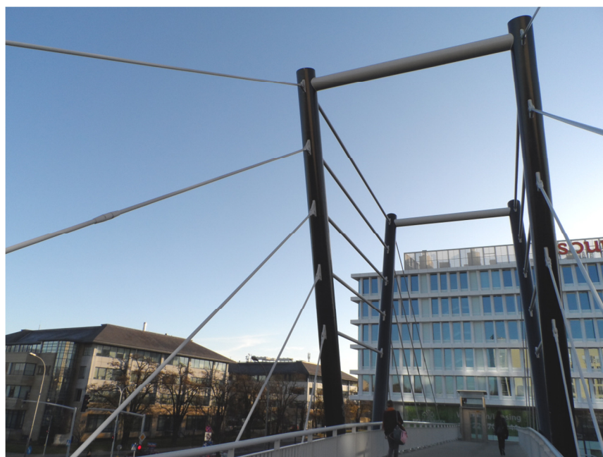
Rys. 6.2 Przykład zastosowania ciężnych prętowych w kładce nad ul. Żwirki i Wigury w Warszawie: system Macalloy 460 [zdjęcie własne]
