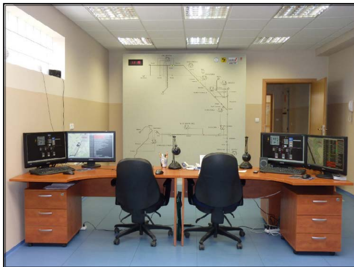
Ryc. 4.12. Stanowiska dyżurnych wraz z tablicą synoptyczną układu zasilania sieci trakcyjnej w Centrum Dyspozycji Mocy i Ruchu (22.04.2011 r.).
