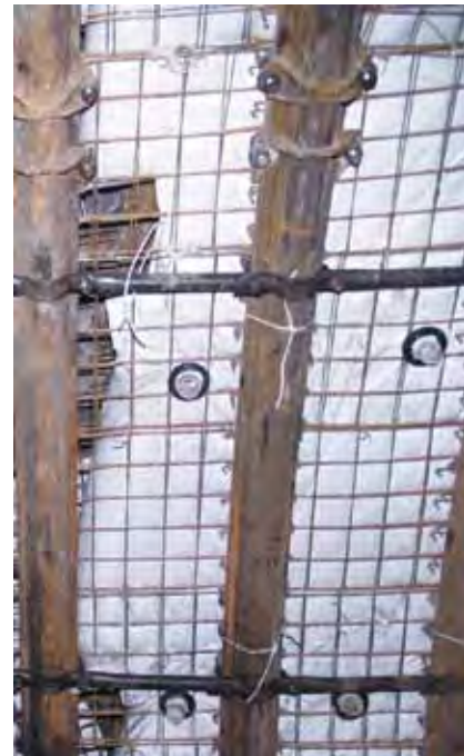
Rys. 6. Przestrzeń między odrzwiami obudowy wypełniona rękawkami ze spoiwem mineralno-cementowym. Fig. 6. Double timber space filled with the cement-mineral binder by use of lining with inserted hose
