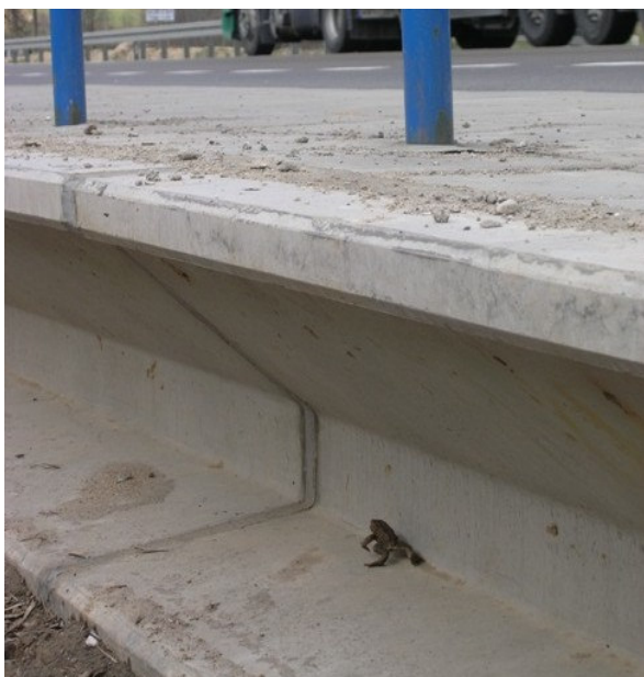
Fot. 22 Ogrodzenie typu „C” w miejscowości Jeziorki, na drodze krajowej nr 8. Dobrze widoczna tzw. „stopa” – podstawa płotka, po której porusza się płaz (źródło: GDDKiA, portal internetowy).
