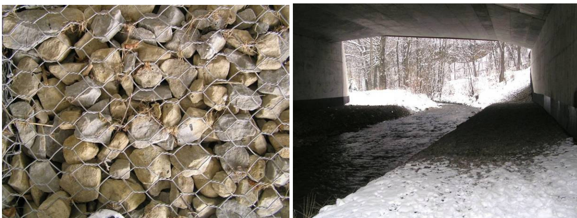
Fot. 10 i 11 Po lewej stronie umocnienie brzegu niezbyt przyjazne zwierzętom – żwir umocniony siatką. Na prawym zdjęciu - widok na umocniony brzeg pod mostem. W głębi, z prawej strony widoczna skarpa, która utrudnia zwierzętom korzystanie z przejścia pod mostem (źródło: fotografie autora).
