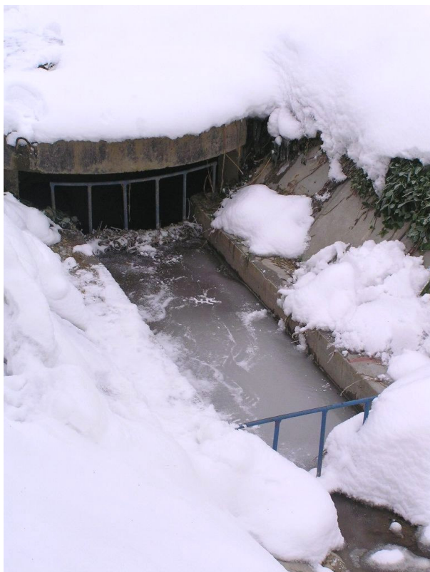
Fot. 23 Wlot do studzienki odwadniającej w pobliżu górnego przejścia dla zwierząt koło miejscowości Węgierska Górka (droga krajowa nr 69). Widoczny jest szeroki rozstaw prętów w kracie zabezpieczającej studzienkę (źródło: fotografia autora).
