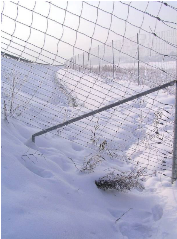
Fot. 16 Szczelina pod siatką wynikająca z nieprawidłowego jej zamontowania. Liczne tropy po drugiej stronie świadczą o tym, iż zwierzęta często korzystają z możliwości przejścia (źródło: fotografia autora).
