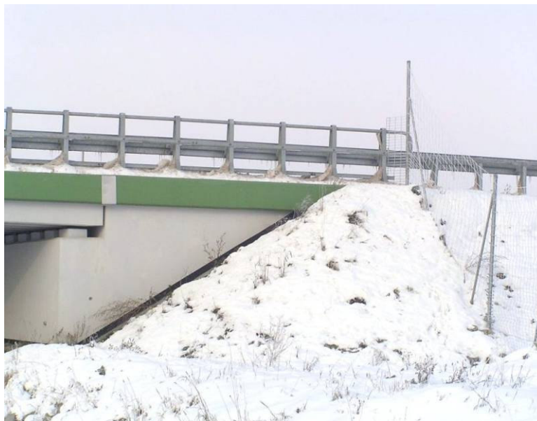
Fot. 15 Źle poprowadzone ogrodzenie – zamiast kończyć się na skraju przejścia (pod mostem), biegnie w górę nasypu, kończąc się tuż przy jezdni (źródło: fotografia autora).
