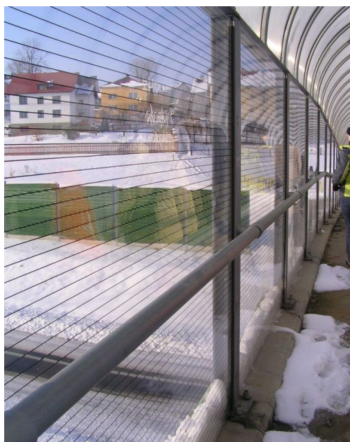
Fot. 19 Prążkowane ekrany akustyczne, przyjazne dla ptaków - kładka dla pieszych nad drogą wojewódzką nr 69 w Zwardoni (źródło: fotografia autora).
