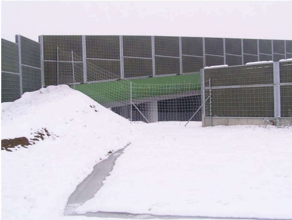
Fot.1 Przerwa w ciągu ekranów akustycznych tuż przy przejściu dla zwierząt. Rozwiązanie takie skutkuje płoszeniem zwierzyny na fragmencie najścia na przejście. Na fotografii tej widoczny jest także inny błąd w projekcji. Ekrany ciągnące się wzdłuż przejścia nie łączą się z ekranami wzdłuż drogi. Kończą się one zaraz za kadrem z lewej strony i nie mają żadnej kontynuacji (źródło: fotografia autora).
