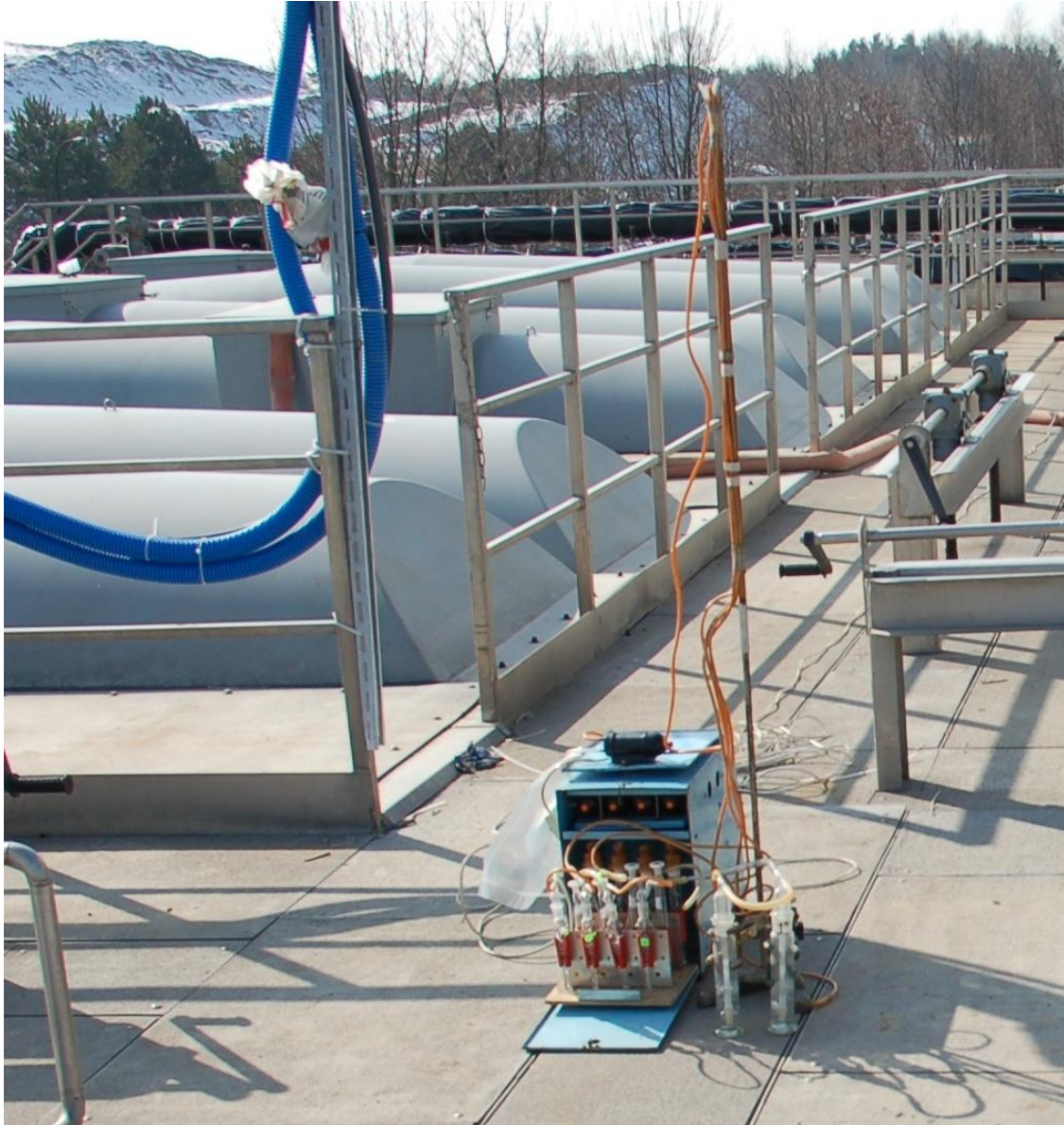
Rys. 4-11 Pobieranie próbek powietrza do oznaczeń siarkowodoru i amoniaku - komora zbiorcza na Oczyszczalni Ścieków „Czajka” w Warszawie (fot. wł.)
