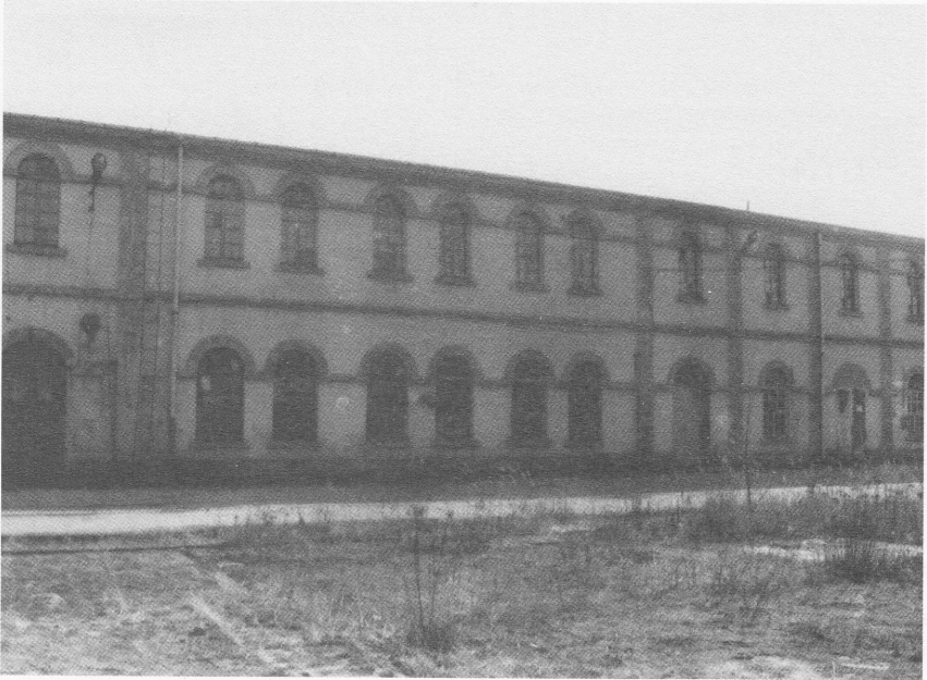
Budynek przędzalni bawełny z XIX w. – stan przed remontem (źródło: Wojewódzki Urząd Ochrony Zabytków w Katowicach Oddział w Częstochowie)
