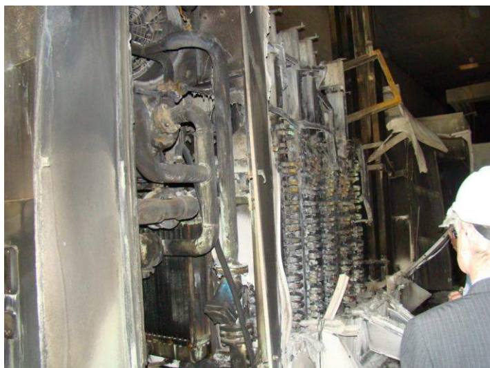
Ryc. 4. Stan urządzeń technicznych po pożarze Źródło: Zdjęcie z akt szkody udostępnione przez TU.
