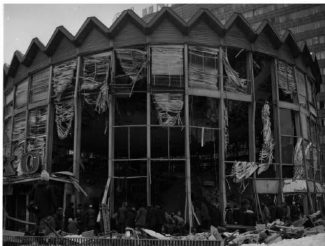
Ryc.10. Widok od zewnątrz zniszczonego budynku Rotundy PKO
