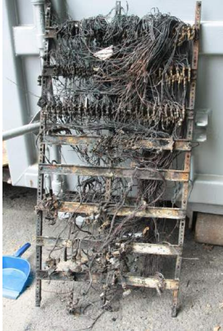
Ryc. 2. Widok spalonej tablicy bezpiecznikowej Źródło: Zdjęcie z akt szkody udostępnione przez TU.
