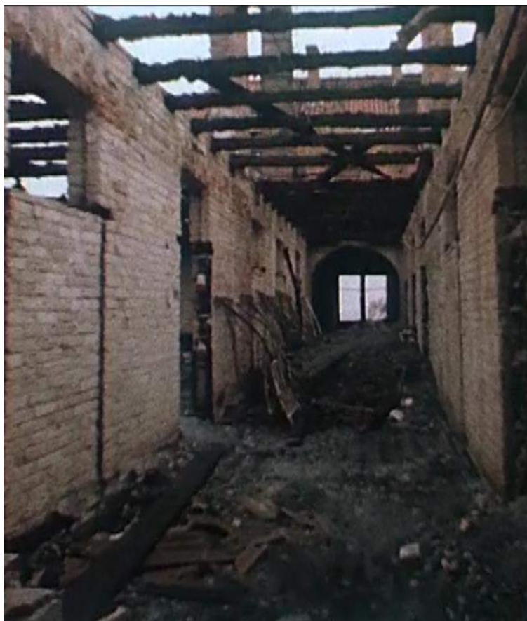
Ryc. 20. Widok zniszczonego przez pożar korytarza Źródło: Reportaż „Znak zapytania”, TWF Poltel, 1980.
