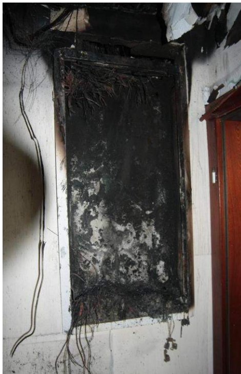
Ryc. 1. Stan miejsca zainstalowania tablicy bezpiecznikowej
