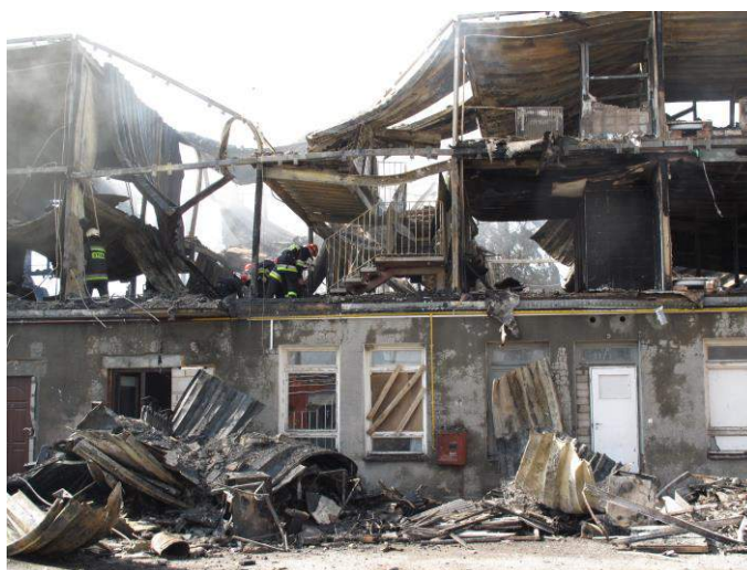
Ryc. 71. Widok zniszczeń spowodowanych pożarem Źródło: Analiza KG PSP – archiwum KG PSP.
