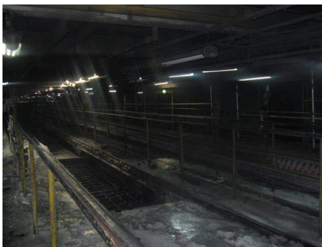
Ryc. 8. Zniszczona galeria podajników rewersowych na ciągu nawęglania
