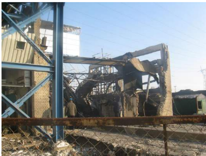
Ryc. 5. Stan budynków technicznych ciągu nawęglania po wybuchu
