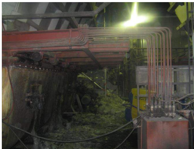
Ryc. 7. Kotłownia po wybuchu – widok od strony podajników
