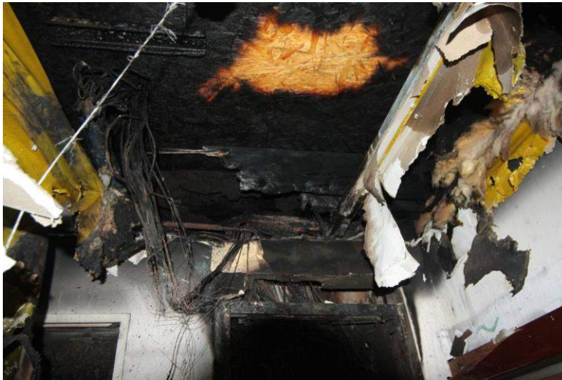
Ryc. 3. Widok miejsca przepalenia legaru stropu nad wyjściem przewodów z tablicy bezpiecznikowej
