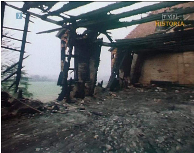
Ryc. 18. Widok zniszczeń po pożarze – poddasze Źródło: Reportaż „Znak zapytania”, TWF Poltel, 1980.
