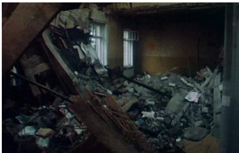
Ryc. 19. Widok pomieszczenia po zawaleniu się stropu Źródło: Reportaż „Znak zapytania”, TWF Poltel, 1980.
