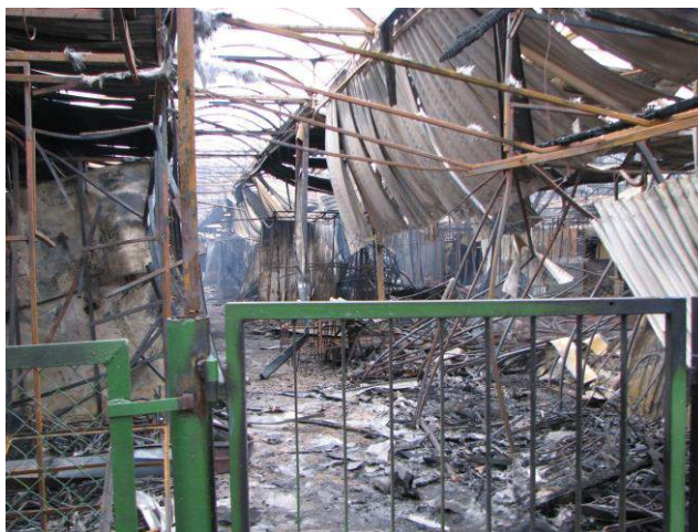
Ryc. 62. Widok zniszczonych stanowisk kupieckich
