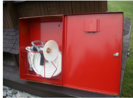
Ryc. 43 Szafka z prądownicą mgłową
