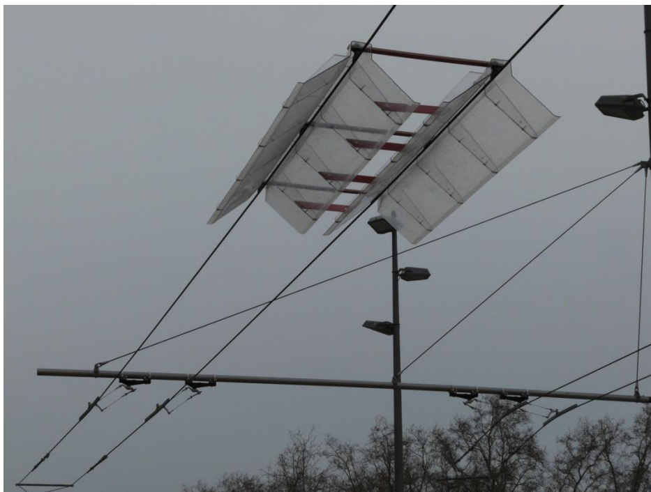
Rys. 4. Specjalne „daszki” do automatycznego kotwienia odbieraków prądu do przewodów sieci trakcyjnej, Castellon.
