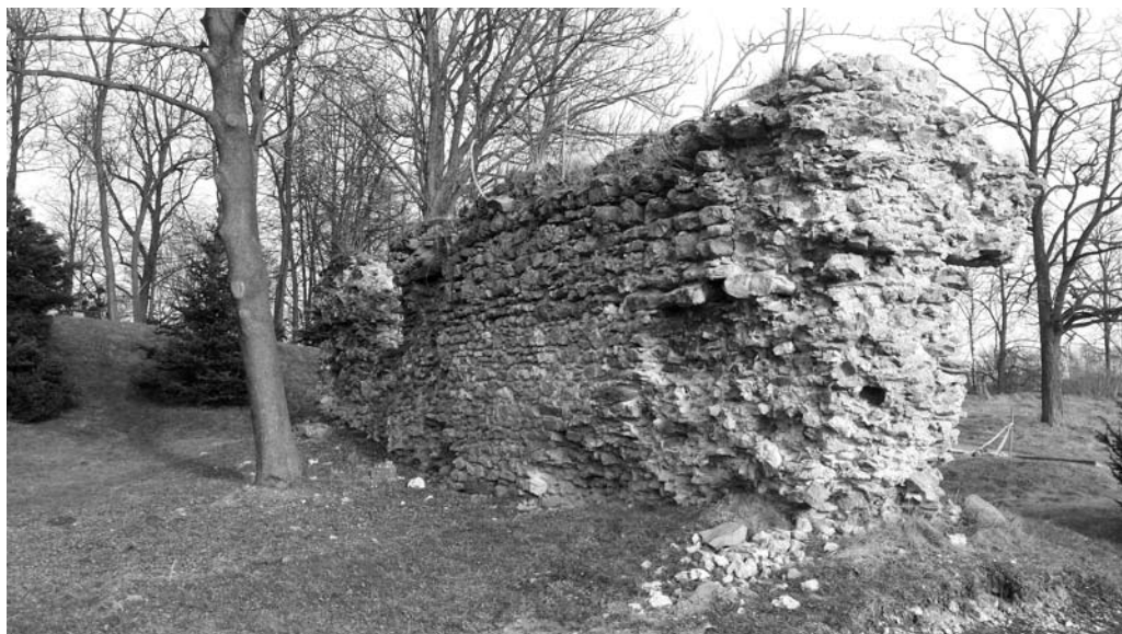
Ryc. 2. Ruina tzw. Domu Kasztelanowej. Stan aktualny – widok od zachodu (fot. R. Herman)
