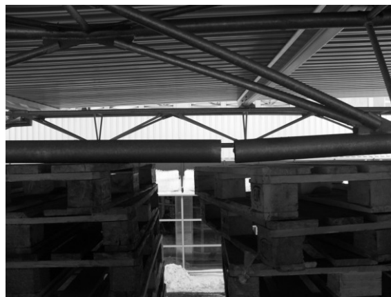
Rys. 4. Uszkodzenie pasa dolnego - zbliżenie
