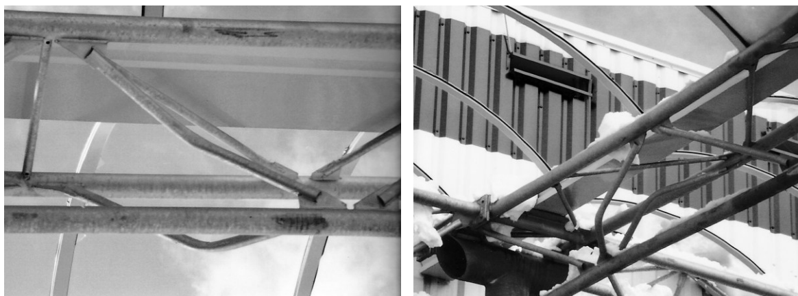
Rys. 7. Wyboczenia prętów wykratowania ścian bocznych - różne ujęcia
