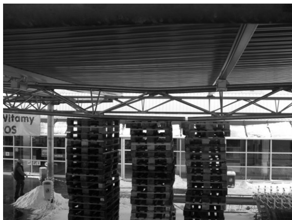
Rys. 3. Widok uszkodzonego dźwigara
