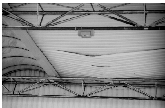
Rys. 9. Zniszczenie blach pokrycia - strona prawa
