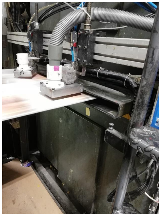
Rys.2. System odciągu mgiełki lakieru – rury odciągowe i kołnierze osłonowe pistoletów natryskowych
