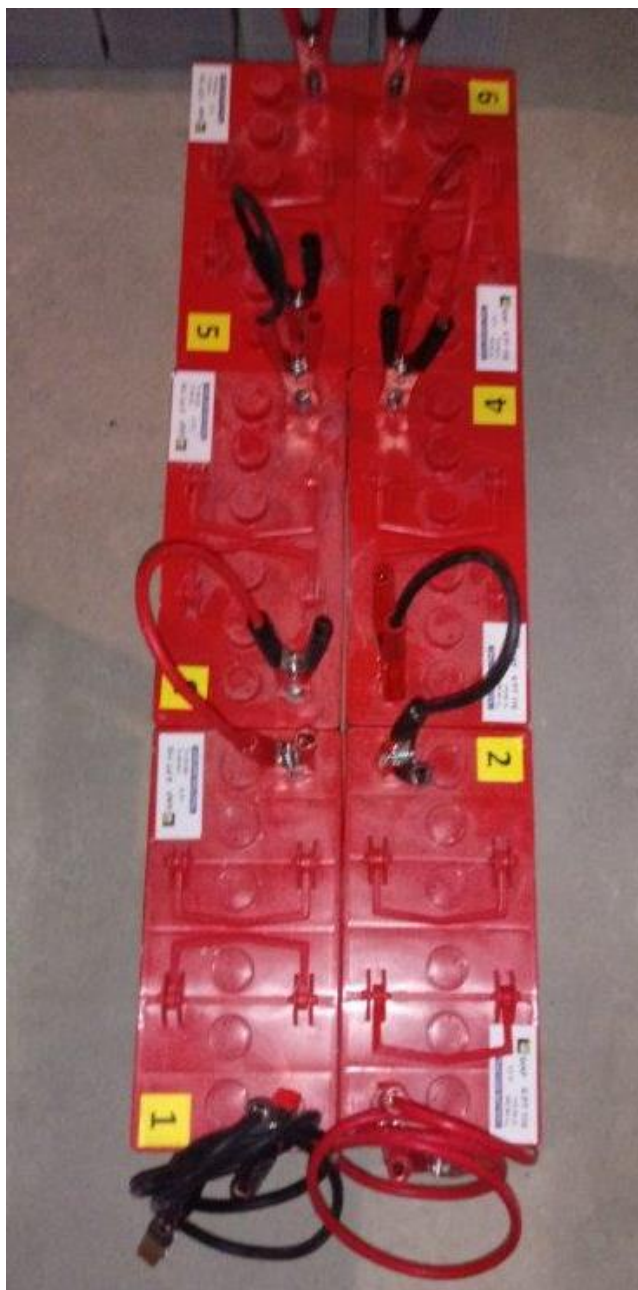
Zdjęcie 15. Połączenie akumulatorów poprzez zaciski sprężyste
