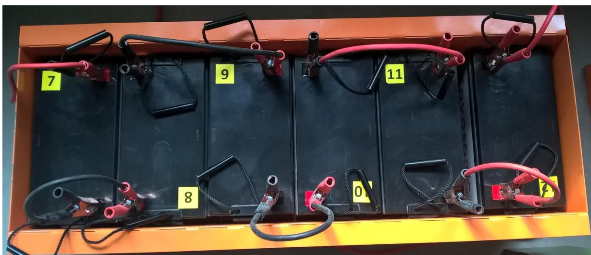
Zdjęcie 25. Połączenie zaciskami sprężystym w stringi akumulatorów ołowiowych z elektrolitem żelowym
