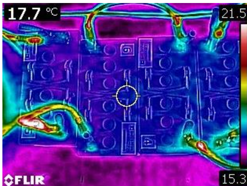
Zdjęcie 17. Zdjęcie łączenia akumulatorów ołowiowych poprzez zaciski mechaniczne wykonane kamerą termowizyjną
