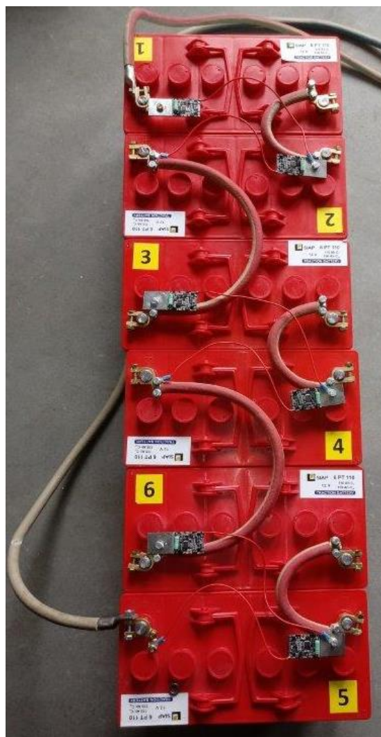
Zdjęcie 21. Połączenie w string akumulatorów ołowiowych z elektrolitem ciekłym z zastosowaniem systemu BMS
