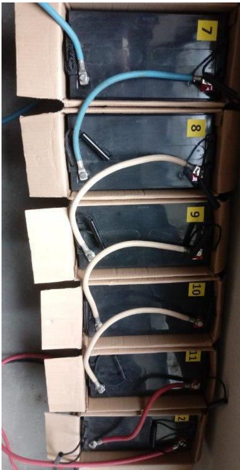
Zdjęcie 22. Połączenie w string akumulatorów ołowiowych z elektrolitem żelowym poprzez zacisk śrubowy (najbardziej optymalne połączenie)
