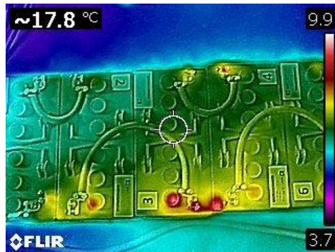
Zdjęcie 19. Połączenie za pomocą klem- zdjęcia z kamery termowizyjnej
