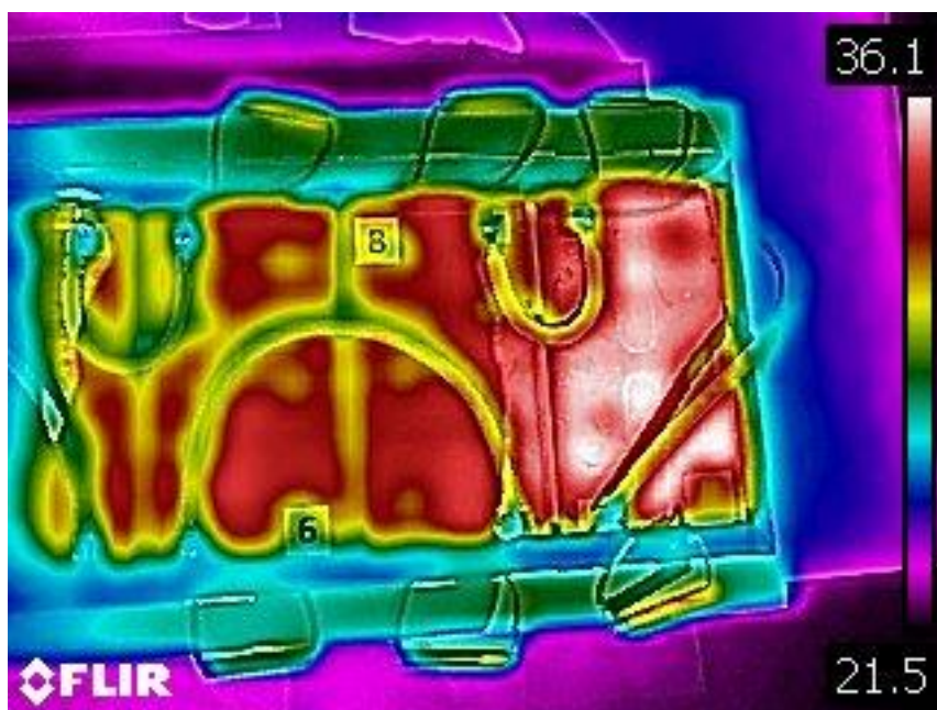
Zdjęcie 23. String akumulatorów żelowych połączony poprzez zaciski śrubowe, zdjęcie z kamery termowizyjnej
