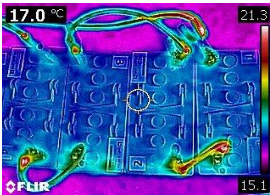
Zdjęcie 16. Zdjęcie łączenia akumulatorów ołowiowych poprzez zaciski mechaniczne wykonane kamerą termowizyjną
