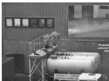
Fot. 1. Miejsce wycieku kwasu
